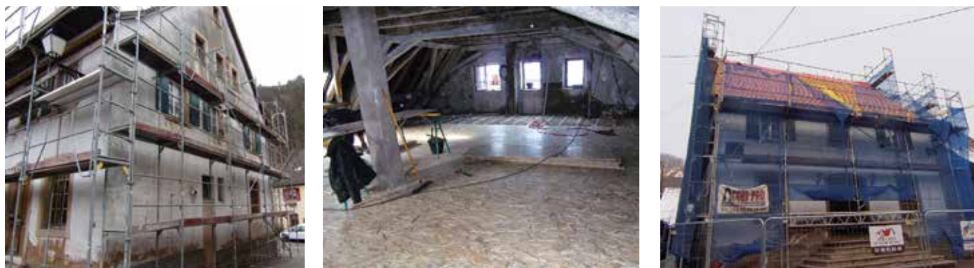
D'importants travaux ont été réalisés, aussi bien à l'extérieur qu'à l'intérieur de la maison communale
